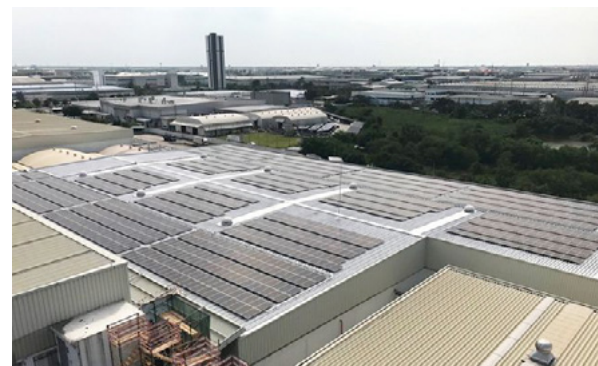
花王インダストリアル（タイランド）の工場に設置された太陽光発電設備
