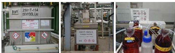
作業所 GHS 表示の例 (左から貯蔵タンク、原料受入れ口、分析室)
