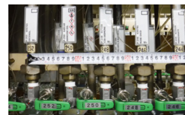
原料サンプリング口の作業場GHS表示(例)
